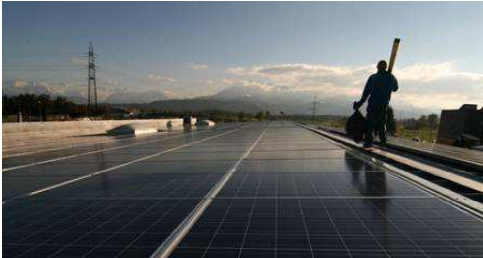
Ansicht des Anlageteils auf der Werkhalle beim Abschluss der Bauarbeiten. Es wurden beide Dachhälften mit Modulen belegt. Solaranlage Pistor-Edisun Power
